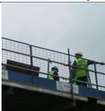
Système de protection – grillage avec plinthe
