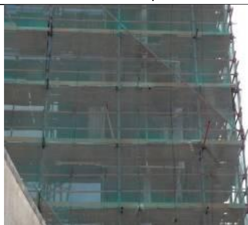
Échafaudage de façade avec filet
