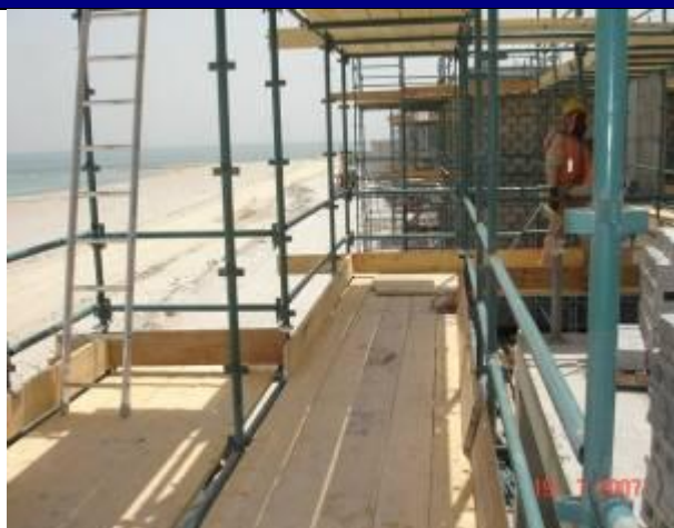
Plateforme avec plancher complet sans aucun débris ni défaut
