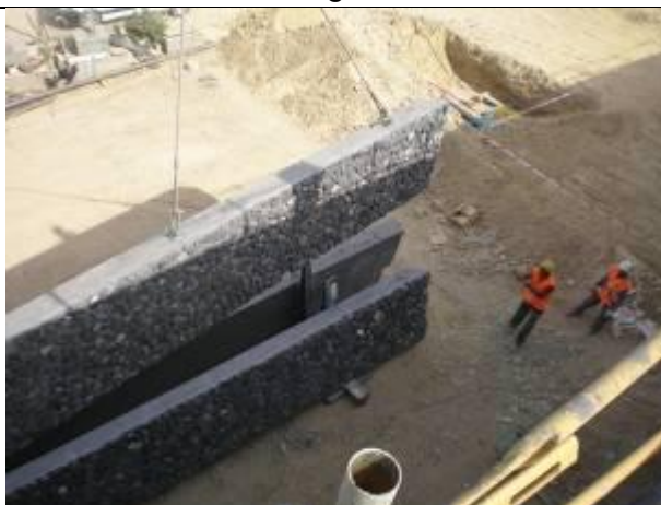
Points d'ancrage fixe et adéquats avec cordes de guidage
