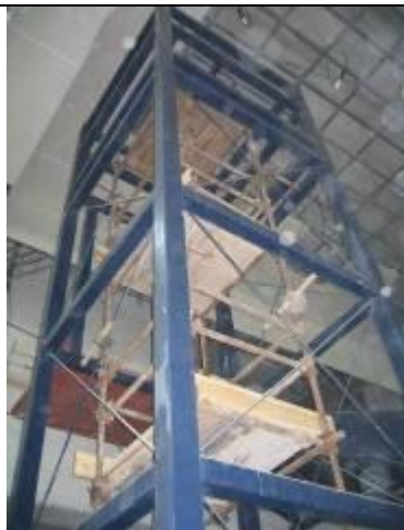
Plateforme d'accès de cage d'ascenseur
